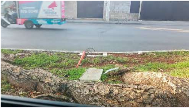
Los camellones son altamente inseguros, entre la vegetación que obstaculiza la visión, cables e instalaciones sin mantenimiento.
